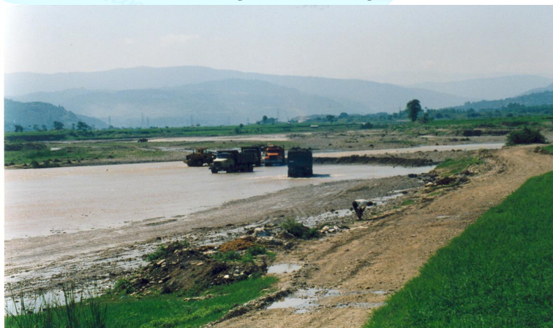
شکل ۲. بهره برداری شن و ماسه از بستر رودخانه تجن ۸۳-۱۳۸۲
